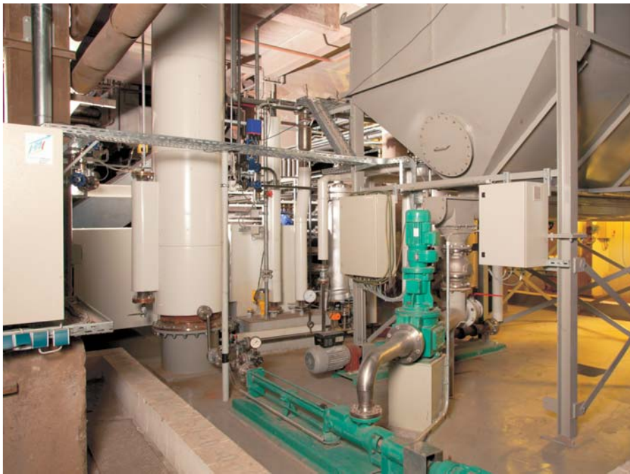
Die Pilotanlage in Schwandorf stellt nach dem ATZ-Thermodruckhydrolyseverfahren Substrate für die Biogas- oder Bioethanolerzeugung her. (Foto: ATZ Entwicklungszentrum Sulzbach-Rosenberg)
